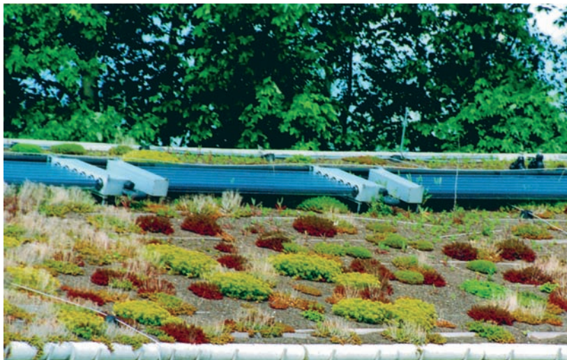
1994: Praktischer Teil des Themas: Auf Initiative der Grünen wurde der Neubau des Kindergartens Weinheim mit einer Solaranlage ausgestattet (s.S. 66).
